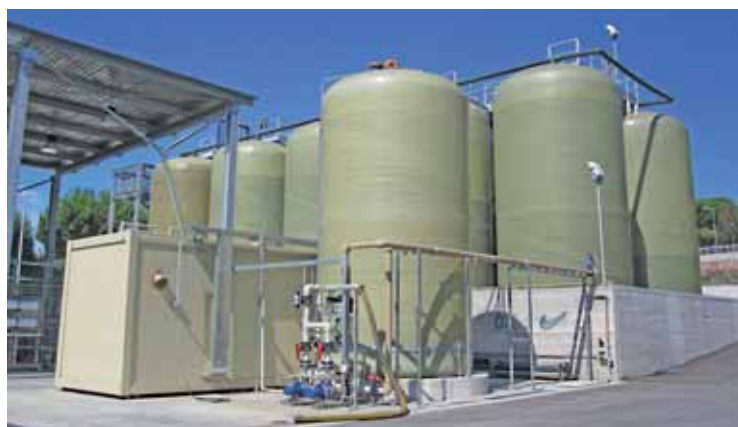
Impianto per il trattamento del percolato installato nella discarica di Terzigno (NA)
