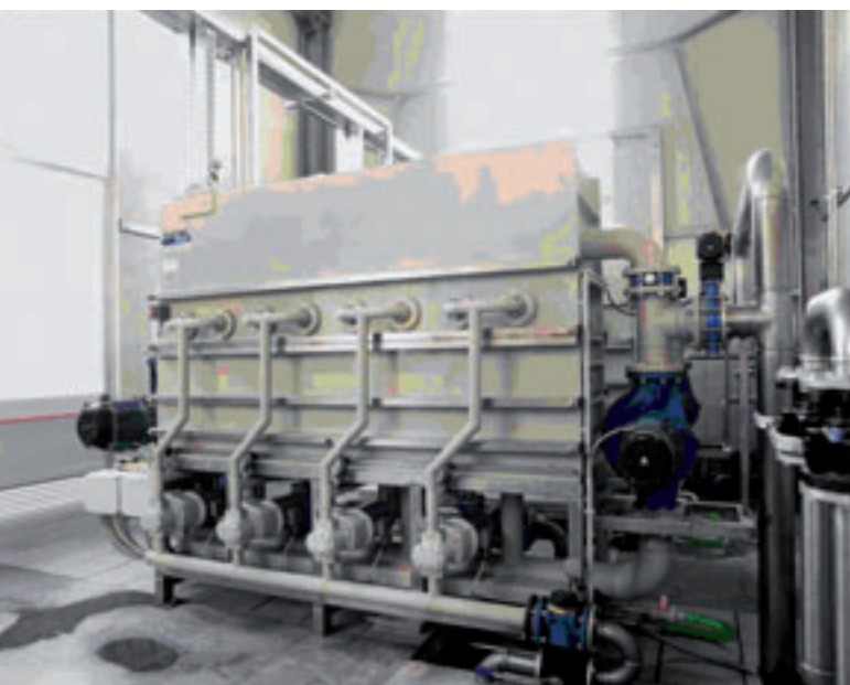
Figura 7 - Impianti di filtrazione Filterpar.
