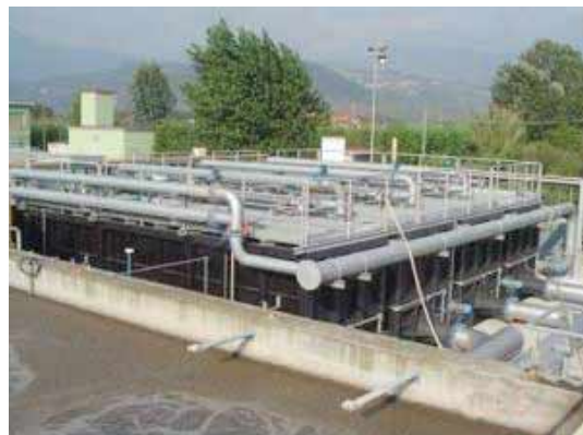
Figura 3 - Vista del reattore Mbr dell'impianto di Viareggio.
