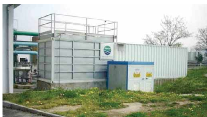
Figura 2 - Vista dell'unità di ultrafiltrazione Smat di Collegno realizzata in container.
