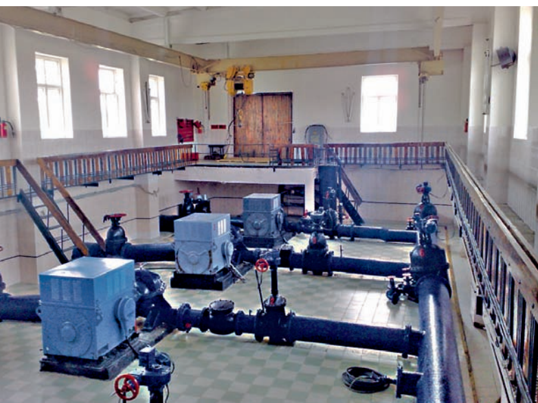
Figura 1 - Stazione di rilancio serbatoio di Smolensk.
