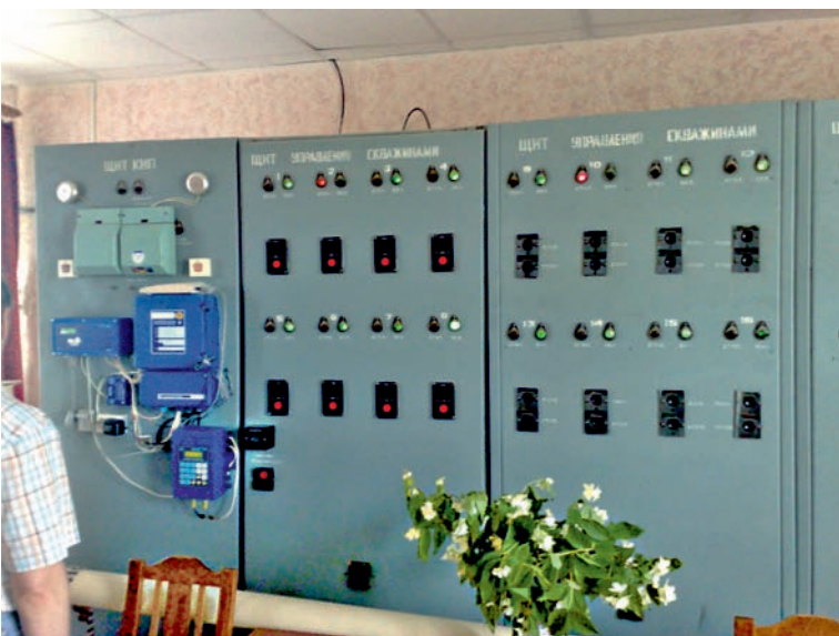
Figura 2 - Quadro comando stazioni di pompaggio.
