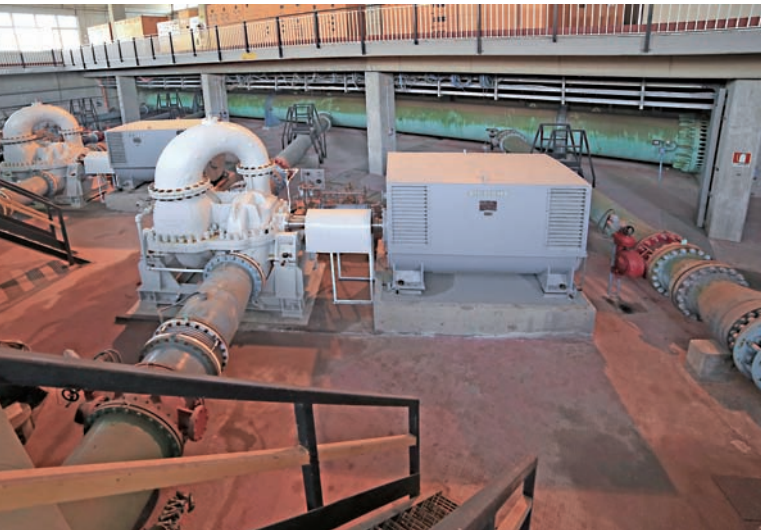
Postazione di Parco del Marchese, pompe di sollevamento equipaggiate con motori in media tensione 6000 V. L'impianto di sollevamento più grande d'Europa, in grado di sollevare fino a 7.000 litri di acqua al secondo e di distribuirli nella Puglia meridionale ed in gran parte di quella centrale. Qui confluiscono le acque potabilizzate del Sinni e del Pertusillo, più di un terzo della portata complessiva dell'Acquedotto. Ospita anche il primo parco fotovoltaico dell'Acquedotto. Cinquemila pannelli distribuiti
