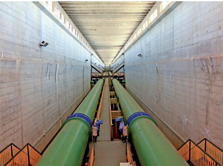
Postazione di Parco del Marchese, condotte d'acqua
