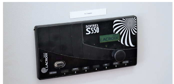
^ Tecnologie di telecontrollo e automazione Lacroix Sofrel
