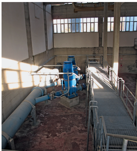
^ La stazione di pompaggio
