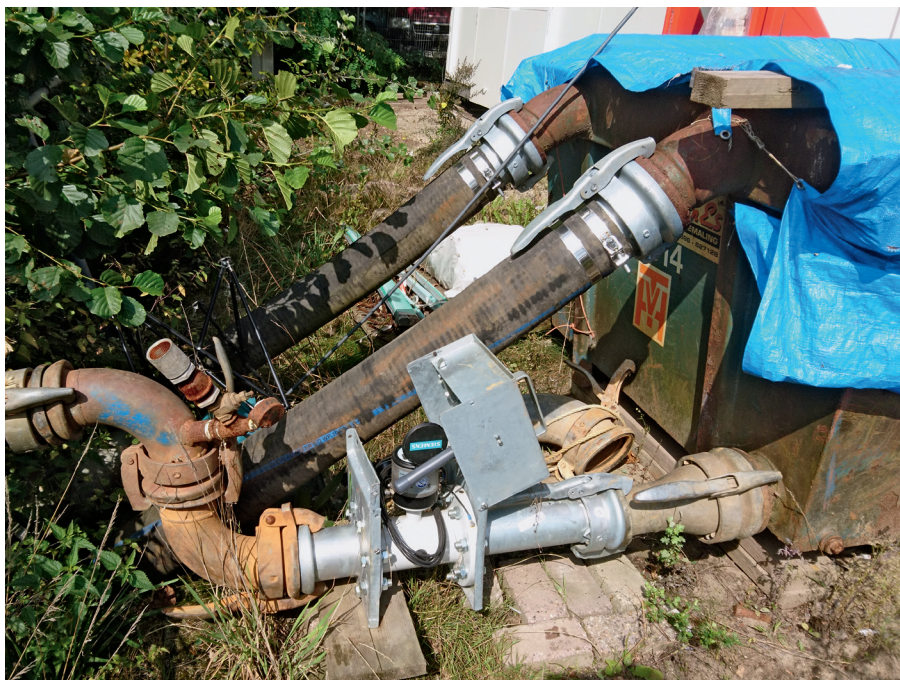
^ La soluzione Smart Handy presenta un misuratore di portata MAG 8000 posizionato nella tubazione di scarico il quale invia continuamente alla piattaforma web del cliente i dati riguardanti l'acqua pompata
