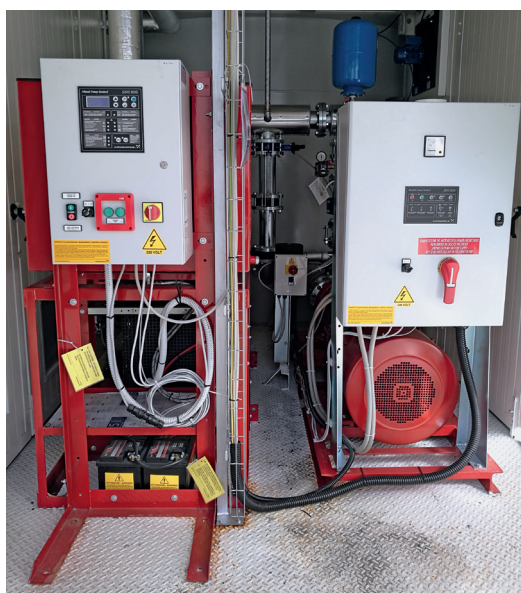
^ Layout impianto nella stazione di pompaggio antincendio: motopompa sulla sinistra, elettropompa sulla destra ed elettropompa di mantenimento al centro in secondo piano
